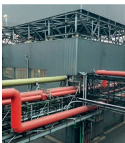
Außenansicht der Kraft-Wärme-Kopplungs Anlage
