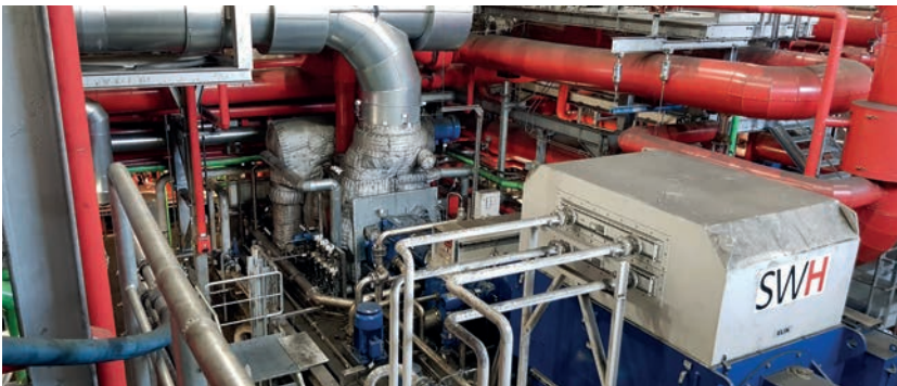
Kraft-Wärme-Kopplungs Anlage Turbine
